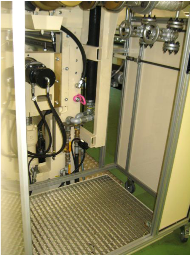
Innenbereich mit Auffangwanne
