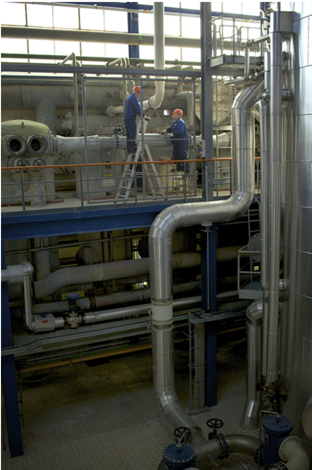
Sicherung gegen Absturz
