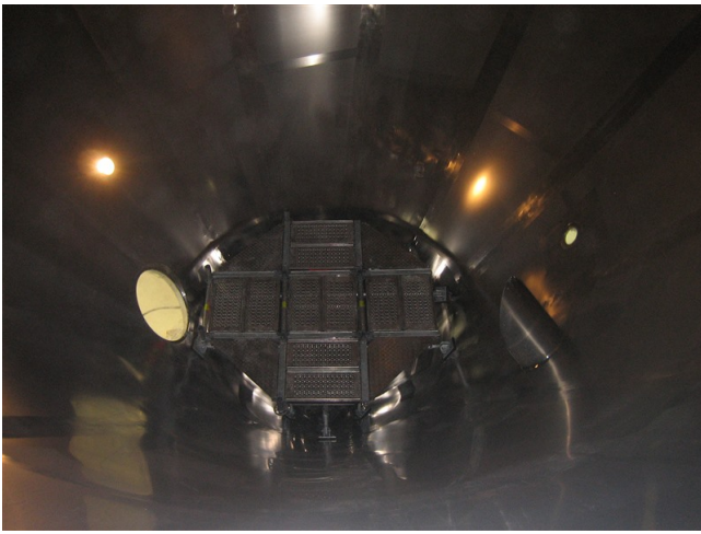
Sprühturm mit Arbeitsbühne - Innenansicht
