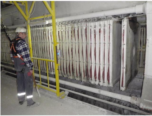
Abb. 4: Der Mitarbeiter positioniert sich hinter dem Schutzgestell
