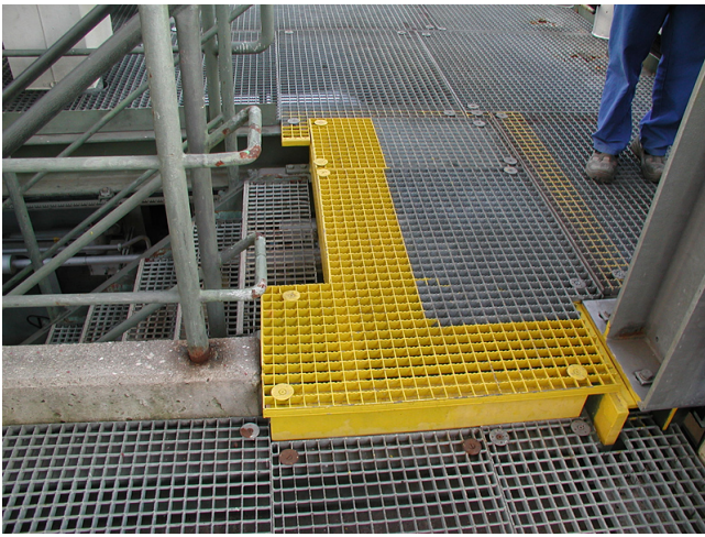
Gitterrosttreppen mit Signalfarben oben
