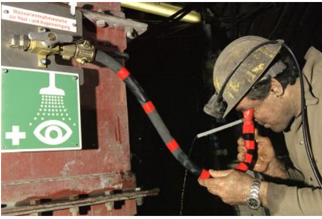
Augenspülstation untertage im Einsatz
